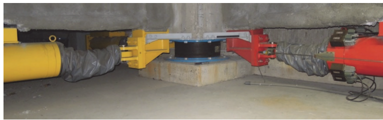
(b) 免震支承(中央)とセミアクティブ免震ダンパー(右)
