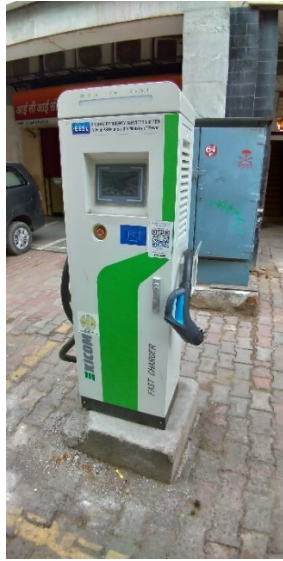
図 3-8 デリー市内に設置された急速充電器 (筆者撮影)
