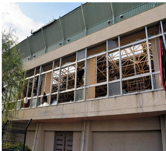
【写真】校舎の被害写真
