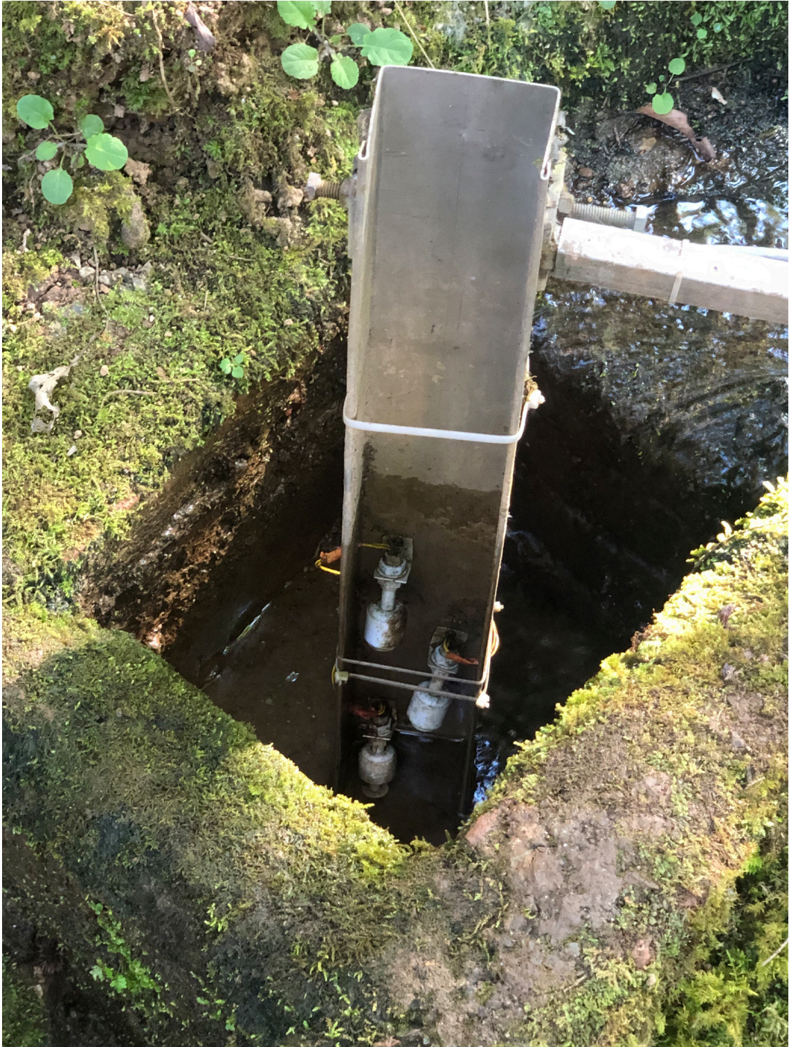
図 B- 4. 浮き具方式水位計測装置
