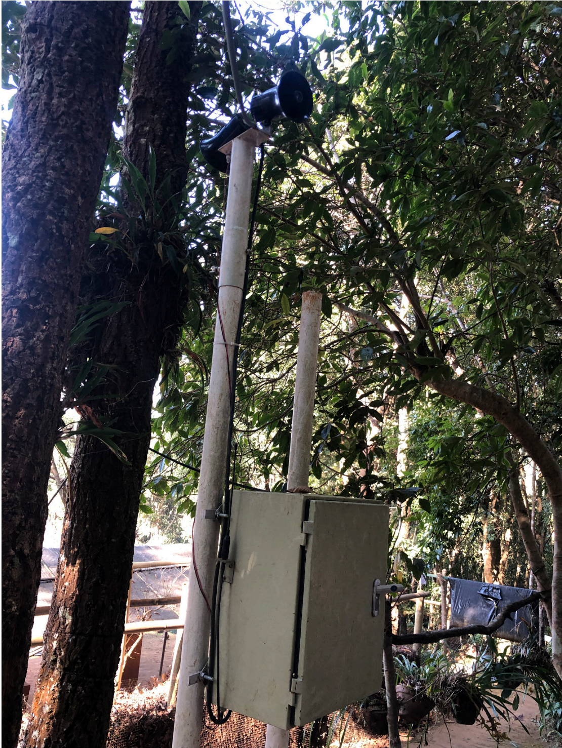
图 B- 7. Alarm Unit
