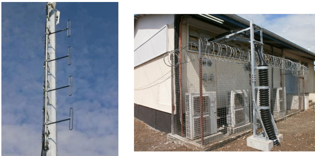
図 1-5 ソロモン諸島に配備された VHF 無線機連絡アンテナと給電施設 [4]
