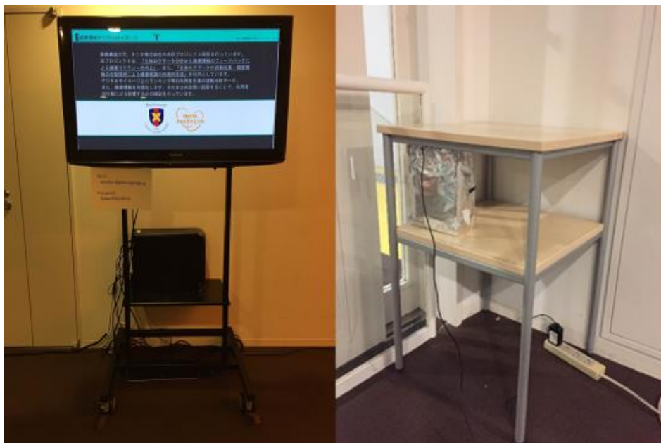
図 28 設置したデジタルサイネージ 図 29 ルータの設置位置
