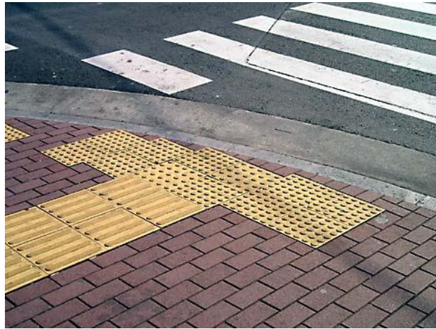
図1-1 点字ブロック
