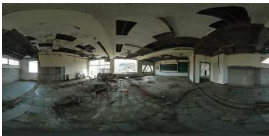
図 A-3 : 宮城県南三陸町戸倉小学校校舎
