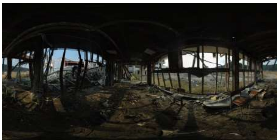
図 A-2 : 宮城県南三陸町戸倉小学校体育館
