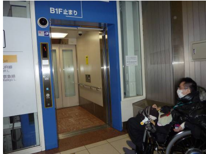
図 2-46 横浜駅東西自由通路のエレベーター
