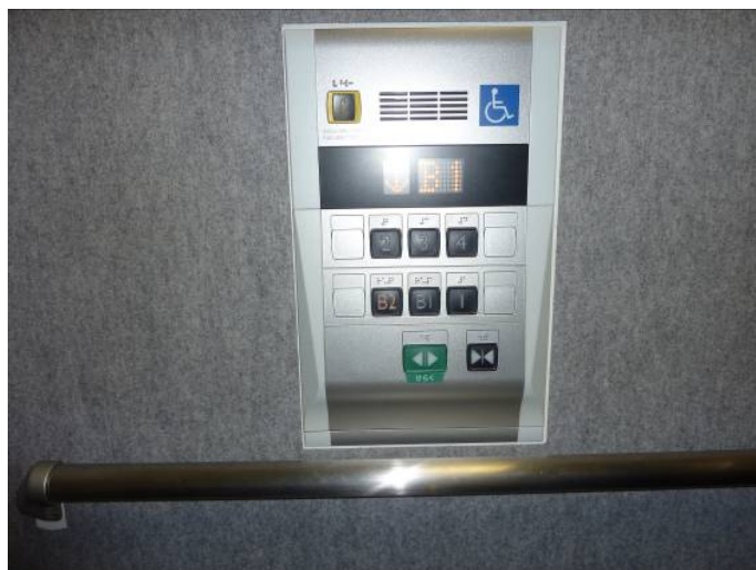
図 3-9 独立館エレベーターのボタン
