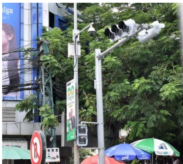
図 4.1: JICA 支援のプノンペン市内の未稼働の新しい信号機 日本の信号機そのもの、監視カメラも設置されている
