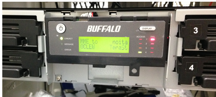
図 4.1: エラーが発生している機材
