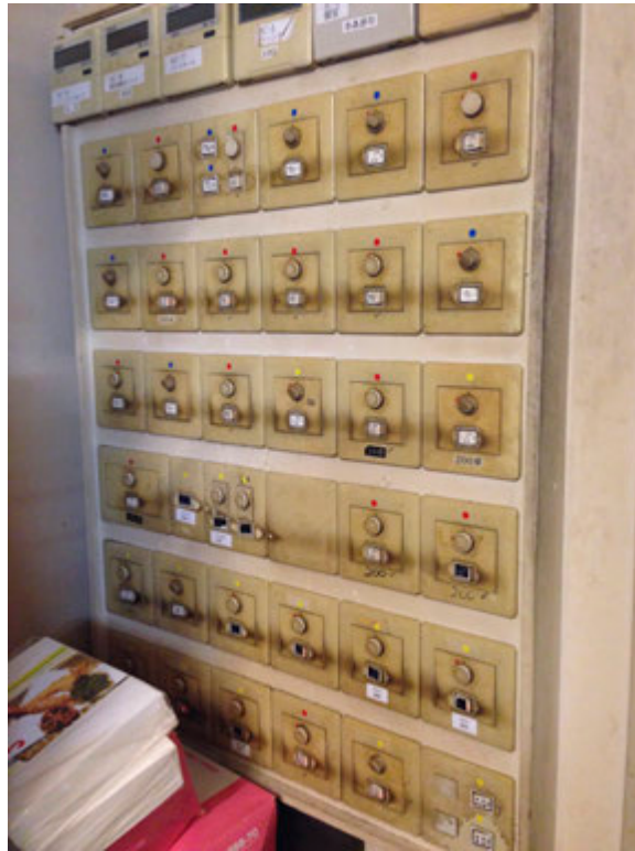
図 3.1 店の照明をコントロール壁スイッチ
