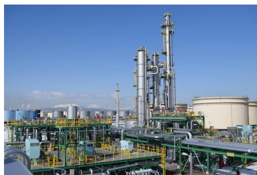
Fig. 3. CCS 苫小牧試験場[3].
