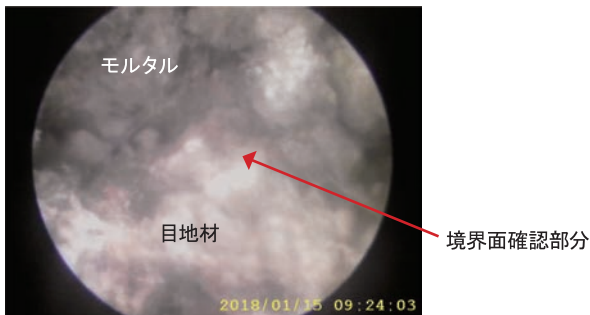
内視鏡で確認された境界面 No.4 外壁表面から約10mmの境界面(空隙有)
