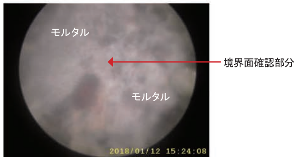
内視鏡で確認された境界面 No.1 外壁表面から約10mmの境界面(空隙有)
