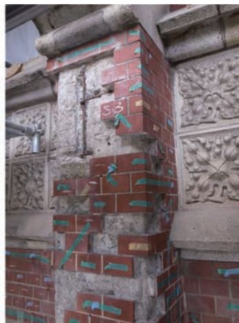
写真 5.3.4 タイル貼り替えの過程で見つかった躯体の不良箇所
