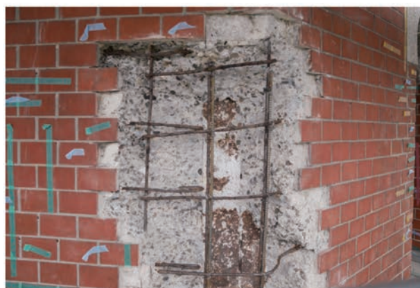
写真 5.3.5 躯体の脆弱部 コンクリート躯体内の錆びた鉄骨
