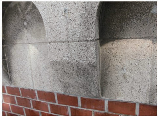
写真 5.3.49 ロンバルディア帯 擬石補修箇所 ひび割れ
