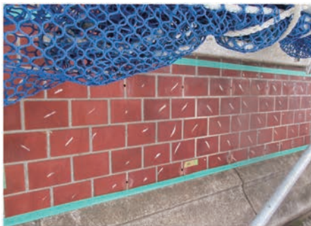
No.3 エポキシ樹脂注入前 タイル浮き範囲
