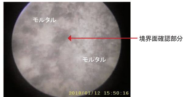
内視鏡で確認された境界面 No.2 外壁表面から約10mmの境界面(空隙有)
