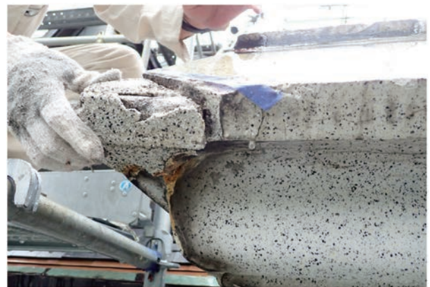
写真 5.3.23 擬石による過去の補修
