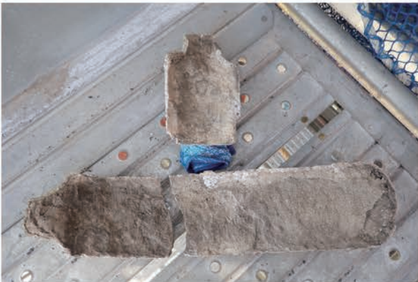
写真 5.3.34 過去の補修によるペンマーク (裏)
