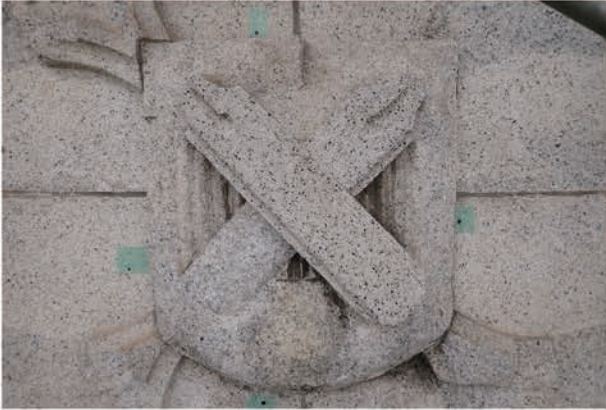
写真 5.3.31 擬石塗りペンマーク (修理前)
