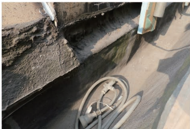
写真 5.2.19 八角塔 パラペット (修理前)
