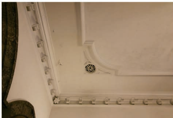
写真 5.4.5 玄関ホール 天井 (修理前)
