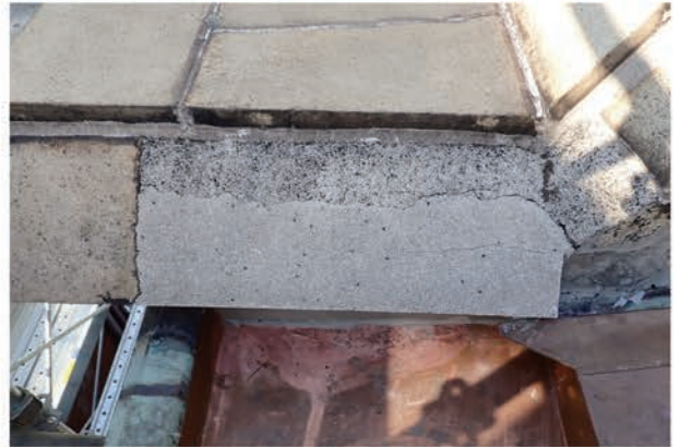
写真 5.3.48 笠木 擬石補修箇所 ひび割れ
