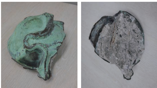
写真 5.2.14 破損箇所 表(左)、裏(右)
