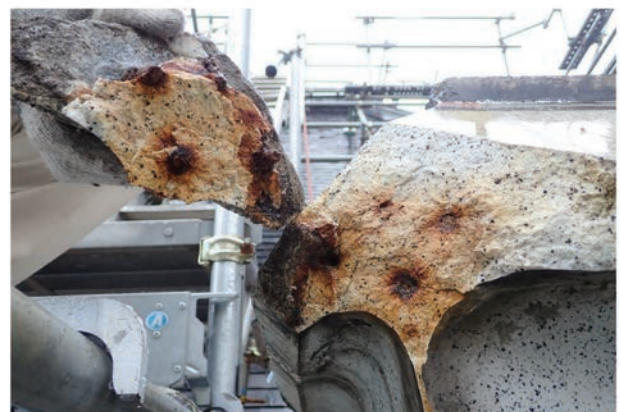
写真 5.3.24 鉄太柄が錆びて折れていた
