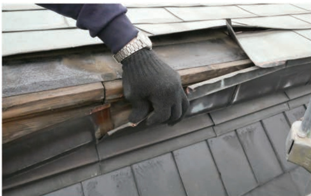
写真 5.2.7 大棟 幕板 はぜの掛り代が少ない
