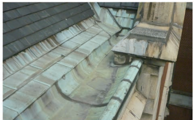
写真 5.2.10 変形した軒先樋(修理前)
