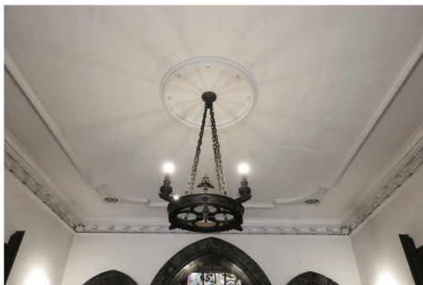
写真 5.4.4 玄関ホール 天井 (修理前)
