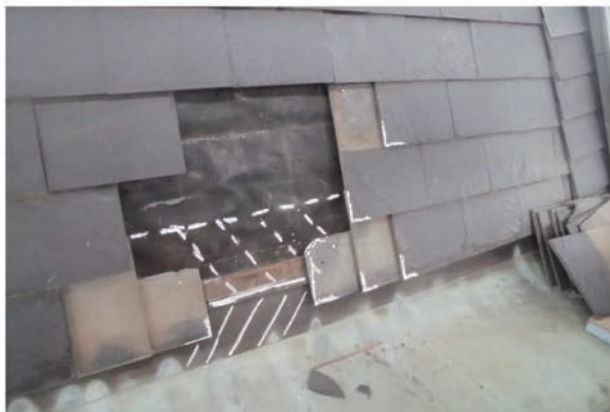
写真 5.2.20 八角塔 屋根立ち上がり部分 (修理前)
