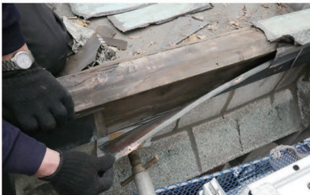
写真 5.2.8 軒先 幕板 銅板笠木と幕板の掛り代が少ない
