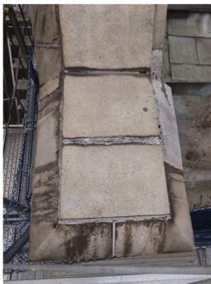
写真 5.3.19 笠木 目地欠損部 (修理前)
