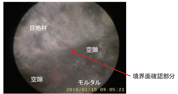
内視鏡で確認された境界面 No.3 外壁表面から約10mmの境界面(空隙有)
