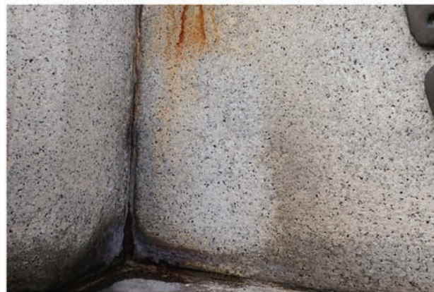
石材に付着した錆の洗浄試験（洗浄後）
