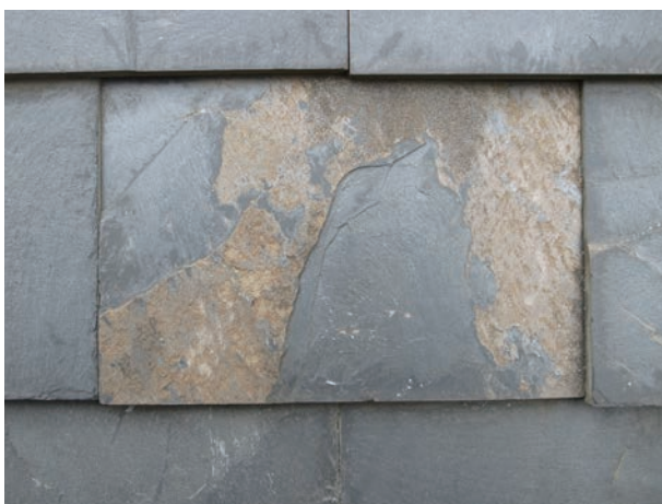
写真 5.2.1 錆の発生したスレート
