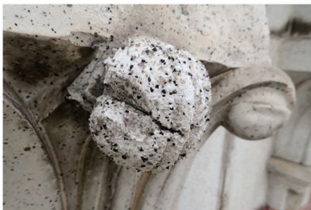
写真 5.3.59 経年劣化により擬石が脆くなっていた
