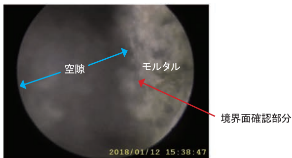
内視鏡で確認された境界面 No.1 外壁表面から約43mmの境界面(空隙有)
