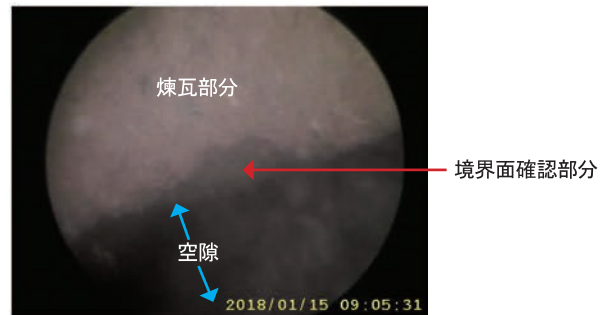
内視鏡で確認された境界面 No.3 外壁表面から約33mmの境界面(空隙有)
