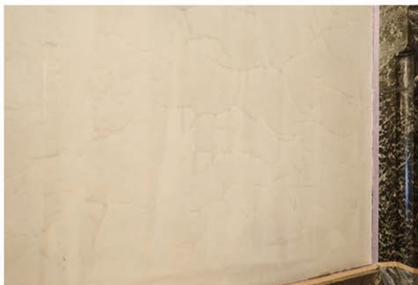
写真 5.4.6 玄関ホール 壁 (修理前)
