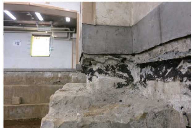
写真4.2.8 第二書庫 コンクリート基礎 壁面に付着したアスファルト
