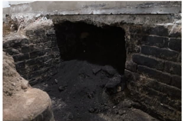
写真 4.9.8 機関室煙道 煙突との接続部 石炭が溜まっていた
