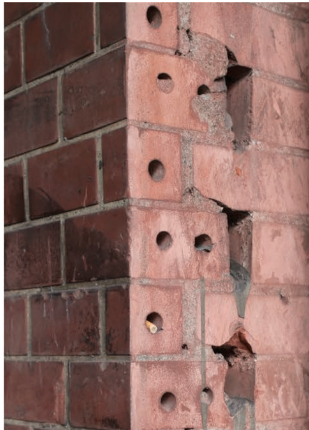
写真 4.3.4 橋台西側表積化粧煉瓦切断面
