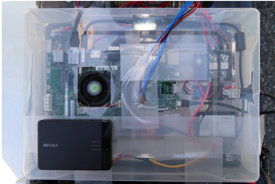
図 4.2: コントロールボードの取り付け
